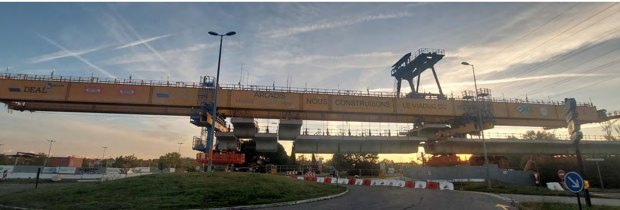
Lanceur LG2 au droit de la Tolosane et des accès Carrefour
